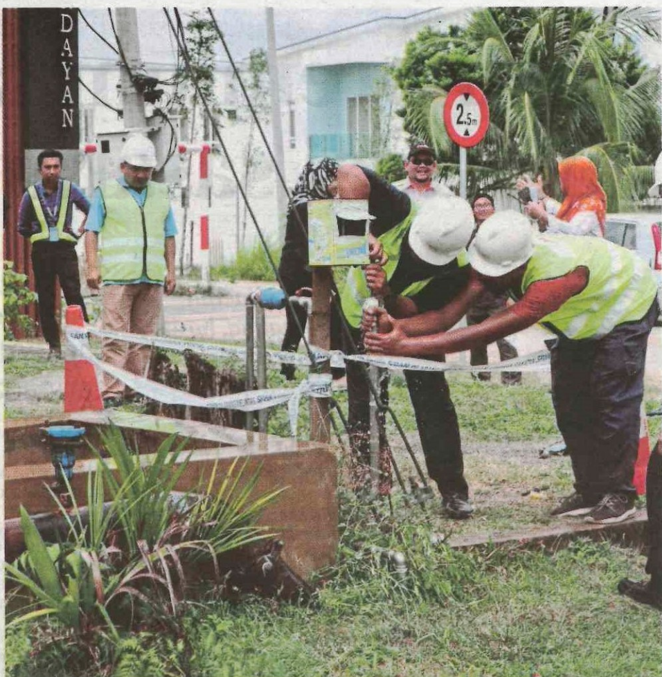
Kakitangan SPAN dan SAINS menyita sambungan paip air yang tidak sah ketika operasi di Sri Sendayan semalam. (Foto Ihsan SAINS)
