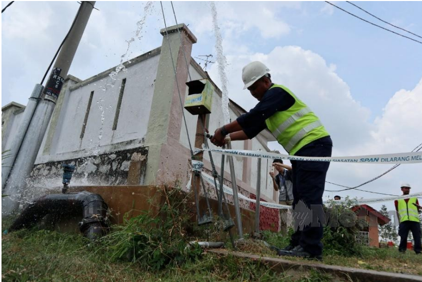
Kakitangan SAINS menyita paip sambungan secara tidak sah dipercayai untuk kegunaan kira-kira 100 buruh pembinaan di Bandar Sri Sendayan, Seremban. Foto Ihsan SAINS
