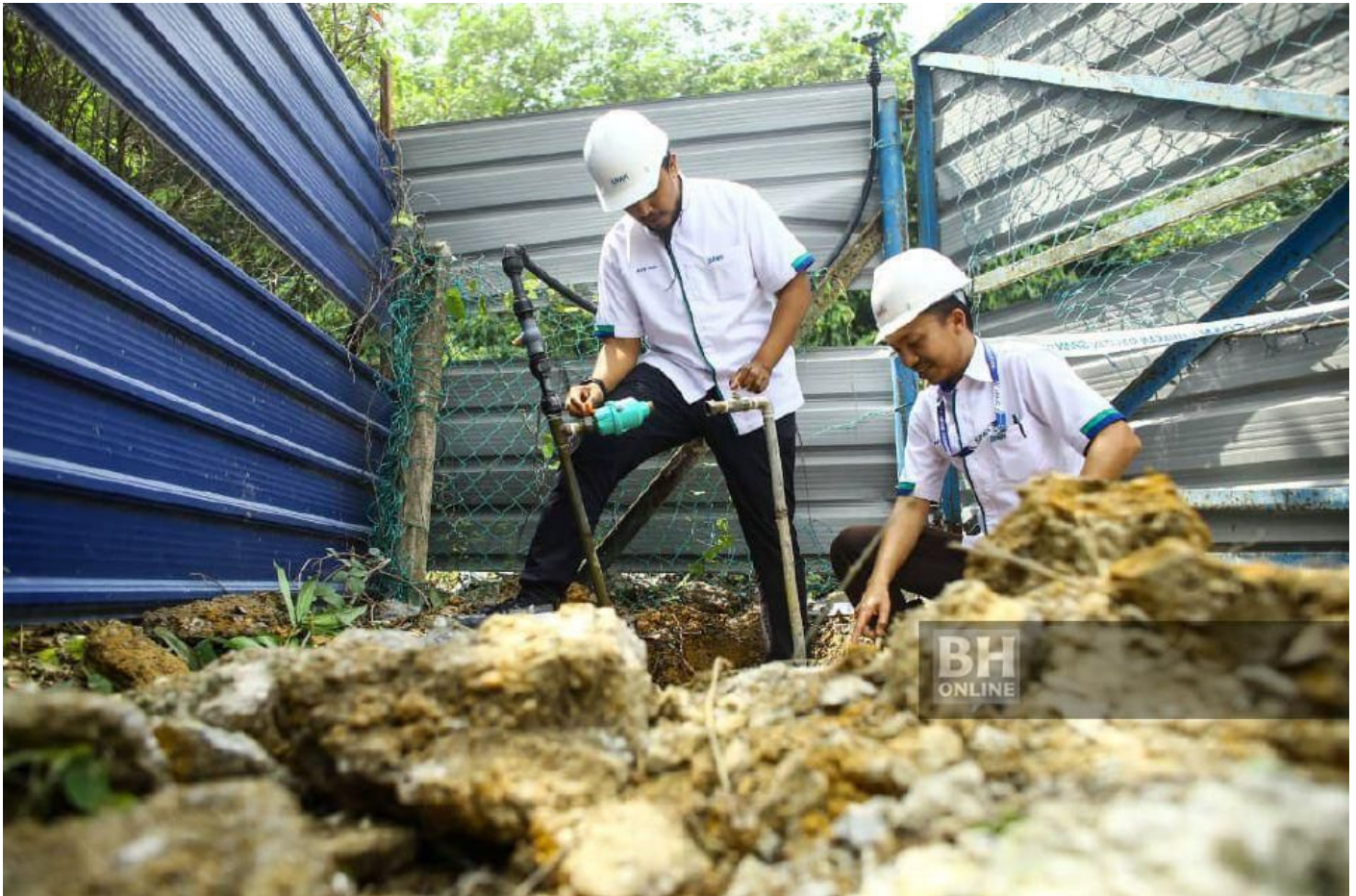
Mohd Fazil (kiri) bersama kakitangan SPAN melihat paip utama milik SAINS yang digunakan tanpa melalui meter air yang dicuri oleh sebuah premis membancuh simen ketika dalam satu operasi mengejut di Kampung Jimah Baru, Bandar Baru Sendayan. - NSTP/Adzlan Sidek
