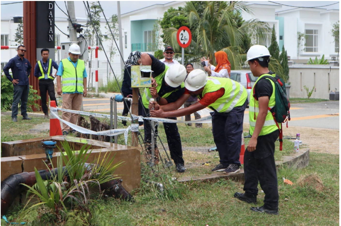
KAKITANGAN SPAN menyita sambungan paip air haram di sebuah tapak pembinaan di Bandar Sri Sendayan. - Foto ihsan SAINS
